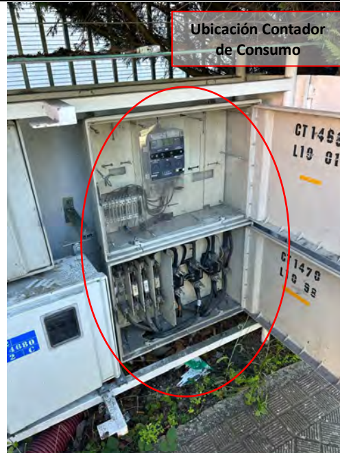
Cuadro de Protección y Medida del Suministro – CPEIP ELORRI
